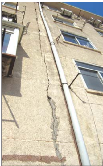
西盛街18号与19号楼之间出现贯穿裂缝。记者 侯艳艳 摄
