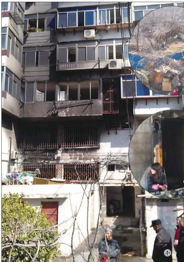
①到7楼都被熏黑,部分玻璃被烤爆。
