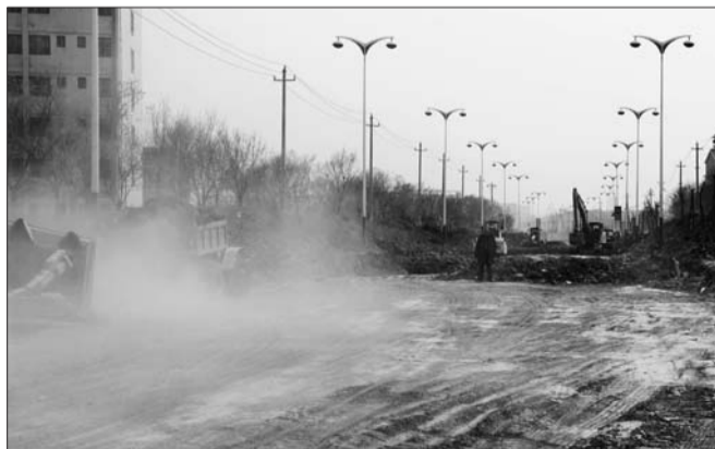
湖滨北大道金卉小区附近路段正在进行维修改造工程。本报记者 王小会 摄
