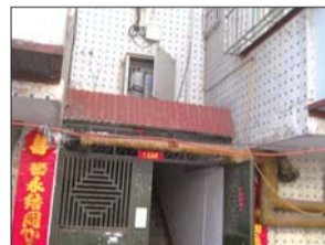
停电居民楼外的电箱被打开等待检修。记者 苑菲菲 摄
