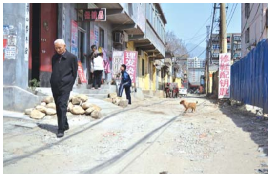
五马社区南坛路年久失修,路面破损。本报记者 陈新 摄
