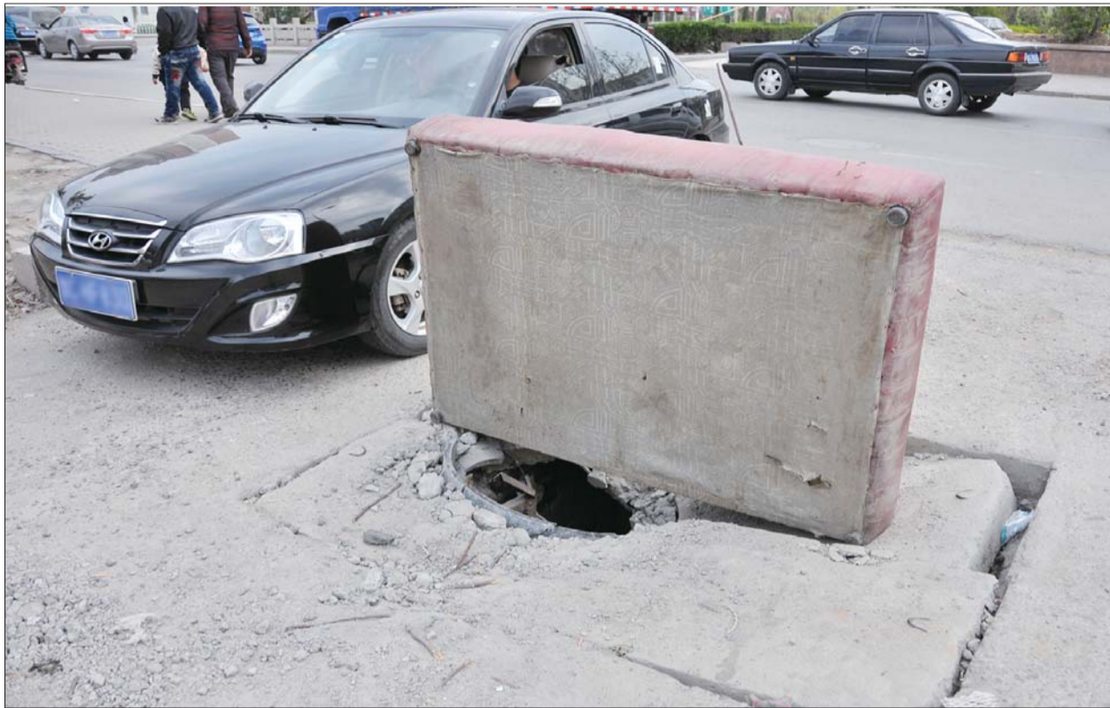
▲14日,在张店世纪路和王舍路交叉口附近,市民用旧床板遮挡塌陷的防护水泥板。 本报记者 王鸿哲 摄
