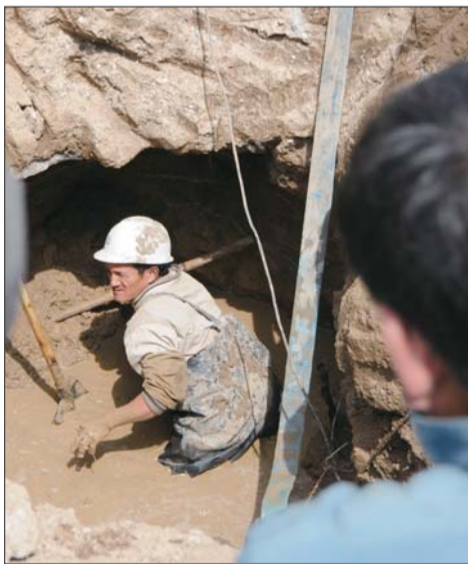
工作人员一直在试图寻找挖断的水管。 本报记者 姜文浩 摄
