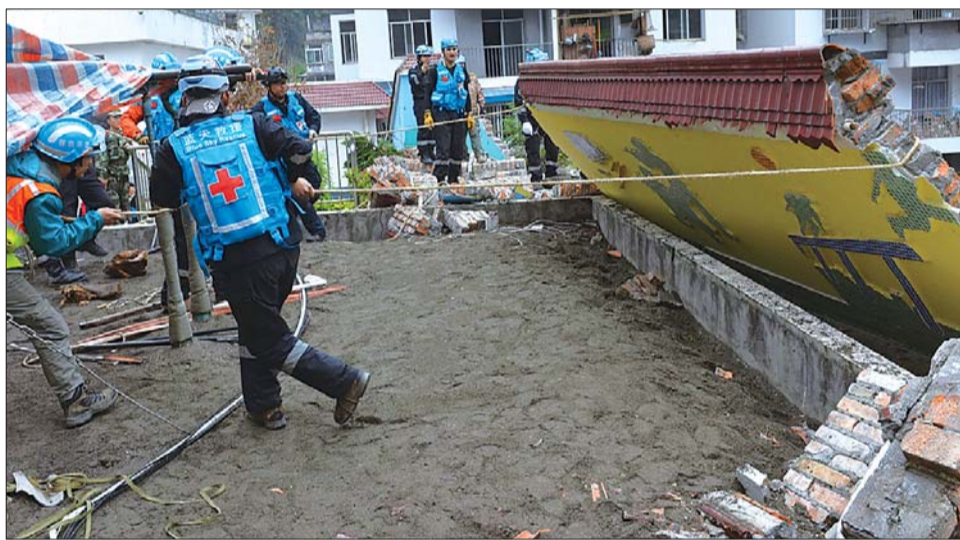
23日，蓝天救援队在宝兴搜救时发现一居民区有一面危墙，随即将其破拆。本报特派记者 郭建政 摄
