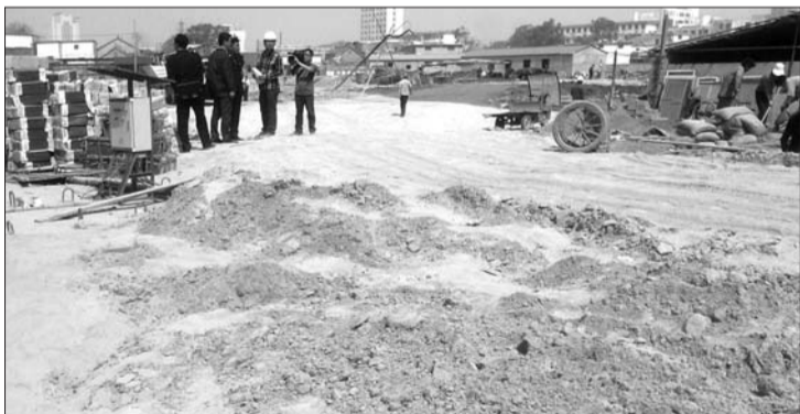
▲城区一建筑工地,出入口尚没有硬化,城管局执法人员站了不大会儿,就感觉空气中沙土弥漫。本报记者 景佳 摄
