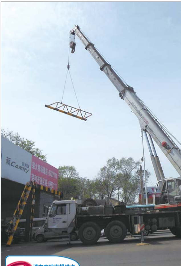
吊车赶到现场吊起断裂的限高杆。 记者 王永军 摄
