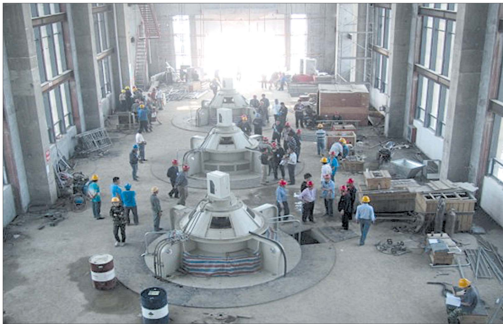
20日, 泰安境内的南水北调工程八里湾泵站成功试运行通水, 该处为梯级提水最高点, 标志东线基本具备通水条件。图为工作人员调试泵房里的抽水泵。 本报记者 王世腾 摄
