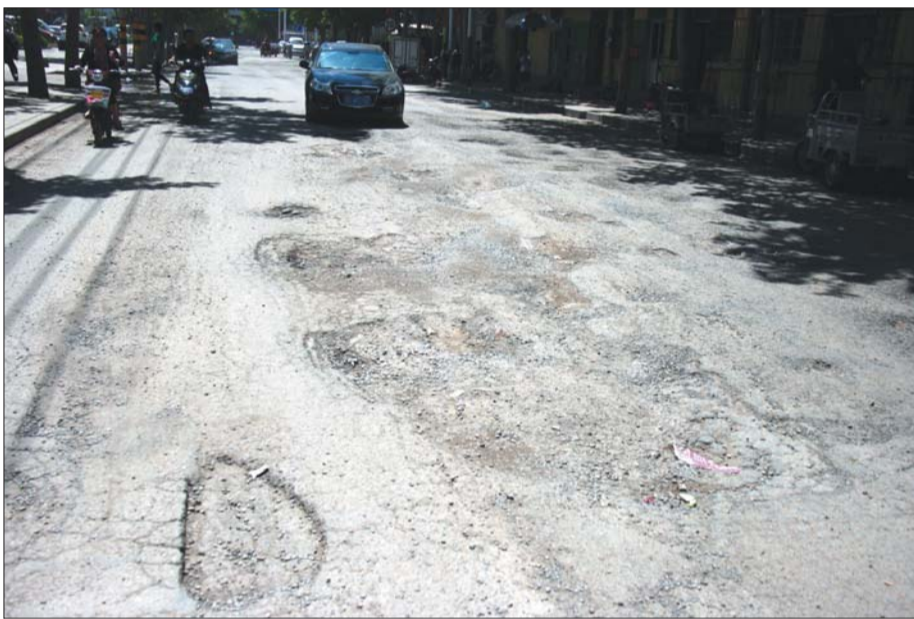
20日, 在潍坊市永安路中段, 坑坑洼洼的路面让车辆颠簸前行。永安路中段(胜利街附近)路面坑坑洼洼, 过往车辆行驶在这段道路上只能缓慢通过。
