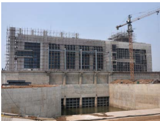
建成的八里湾主体泵站。
