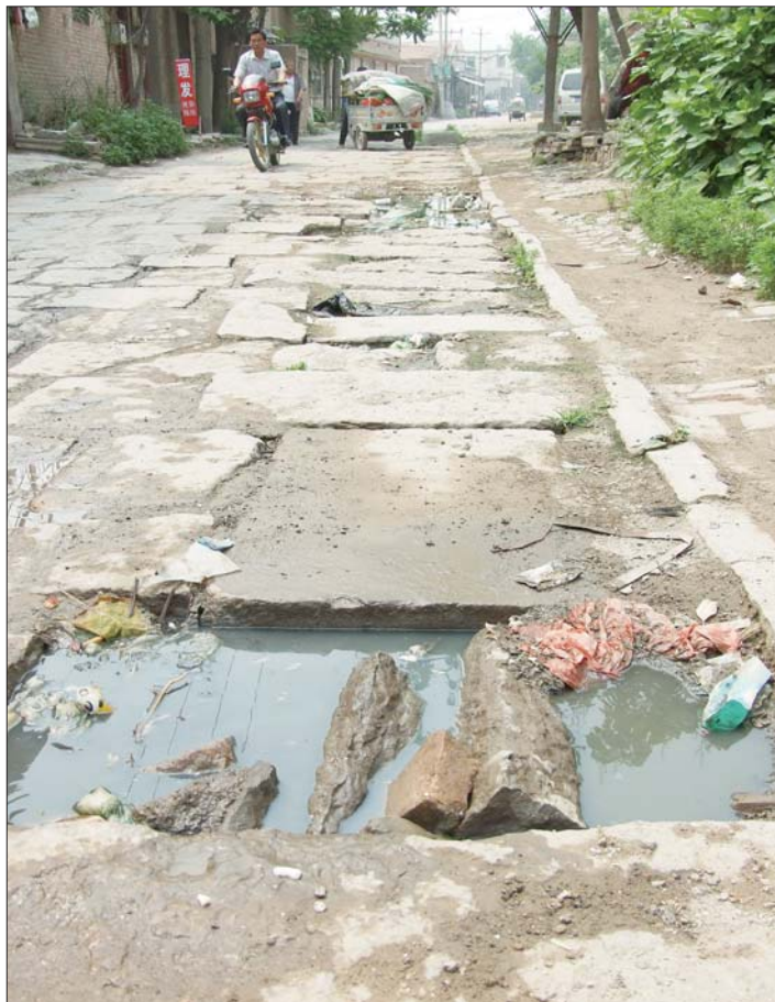
米市街下水道石板断裂下陷,垃圾等杂物堵塞致污水上溢。
