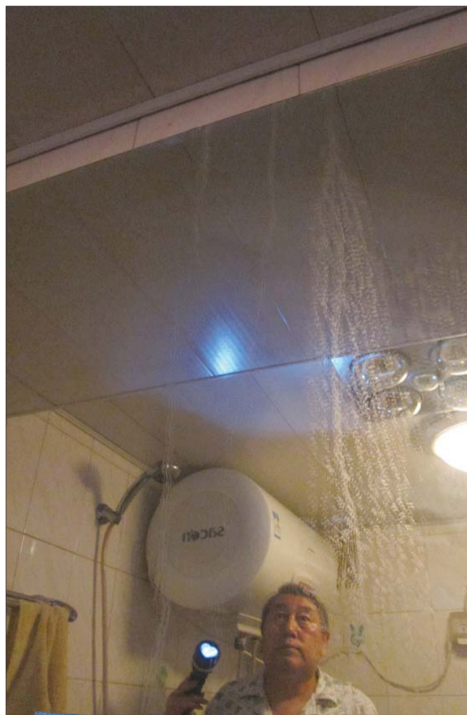
▲楼上漏水渗到楼下住户卫生间的镜子上。记者 刘杭慧 摄
