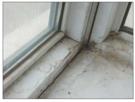
一户居民家阳台上的缝隙。张建业 摄
