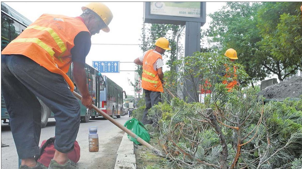
施工方正在清理混进绿化带里的沙石等施工材料。 本报记者 张亚楠 摄
