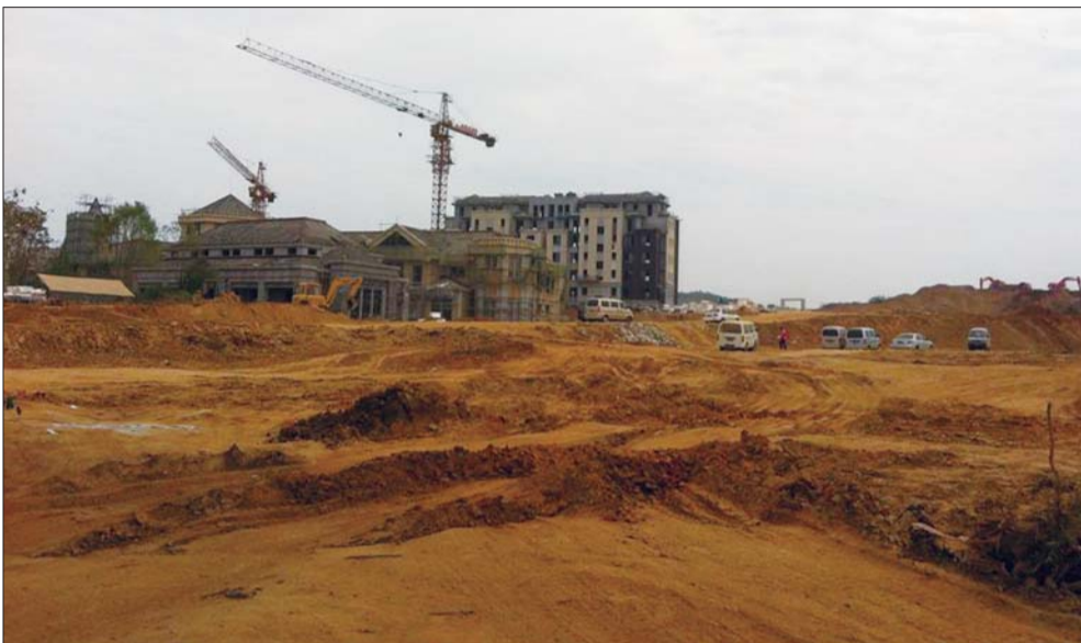
轸格庄立交桥附近的金地格林世界项目正在建设中。记者 李园园 摄
