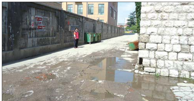
图为破损积水的路面。见习记者 张群 摄
