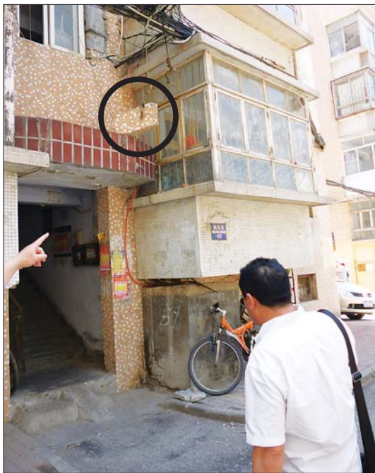
由于承受不住这么多光缆的重量,一块墙皮脱落吊在空中。见习记者 王伟平 摄
