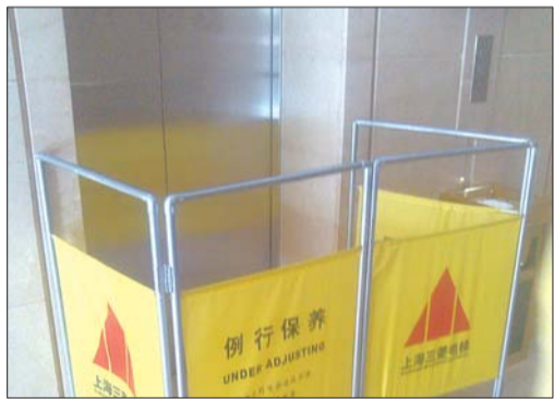
发生故障的电梯已暂停使用。本报记者 张泰来 摄
