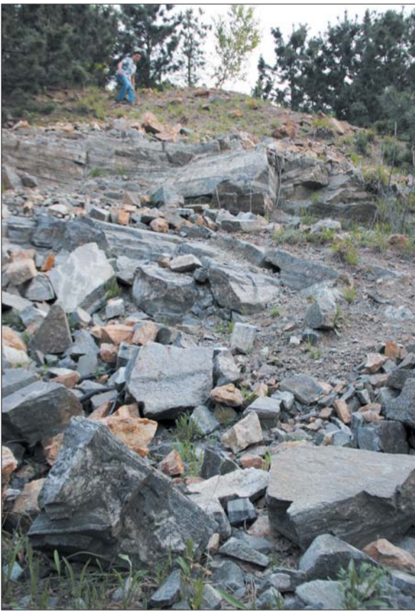
环山路某段两侧山坡上,堆积着大块碎石,随时可能滑落。见习记者 韩逸 摄
