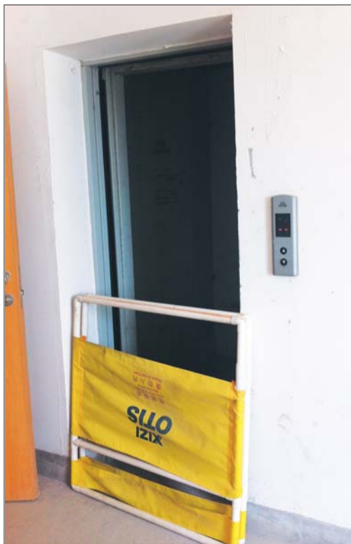
损坏的那部电梯大门敞开停在13层,门口设了围挡。记者 刘杭慧 摄
