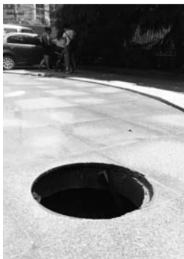
民生街与潍州路交叉口有一处小型喷泉广场,多处排水口的盖子缺失。
