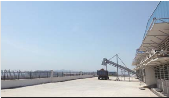
鸡粪不接触地面,直接由传送带送入粪车。
