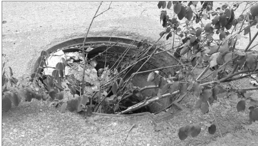
事发现场,下水井盖破损,三分之二的井口都裸露着,井口处插着几根树枝,警示路人。
