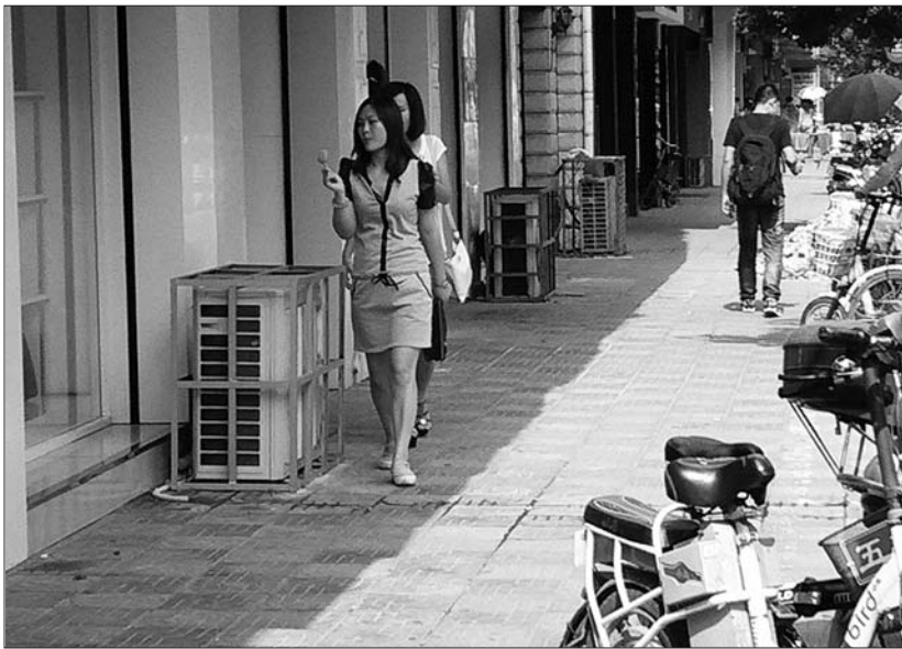
沿街的空调外机贴地安装,热风直吹行人。
