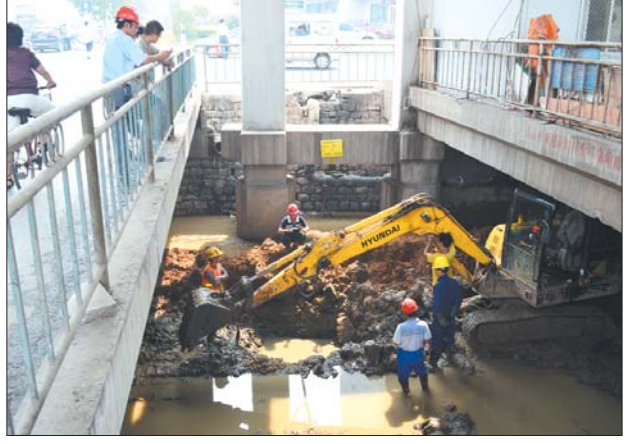
西圩子壕正在铺设大明湖水南调管道。 本报记者 王光营 摄
