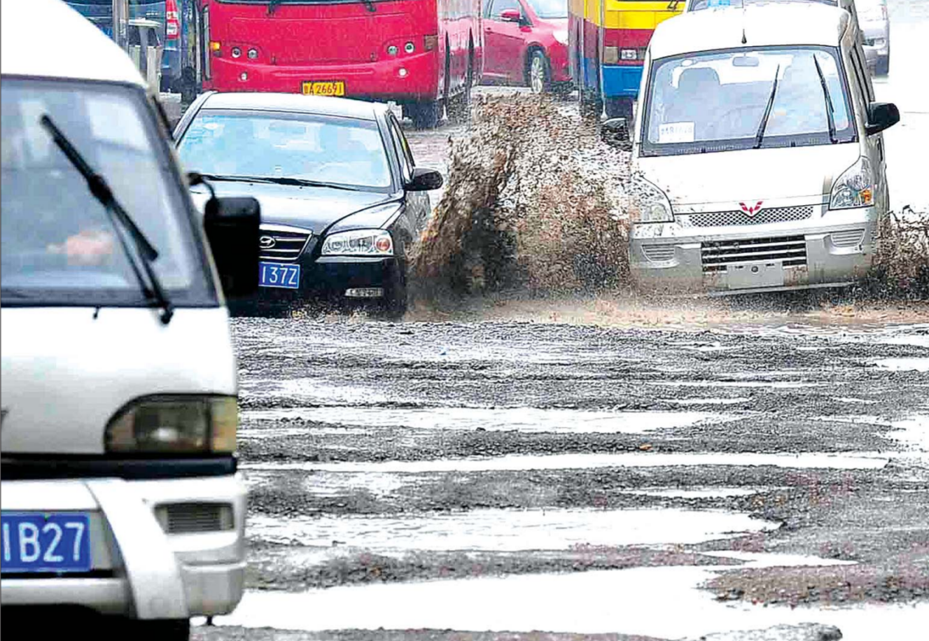
13日,在槐园区兴济河两侧的段兴东路和段兴西路,出现大量坑洼,最大直径四五米。附近居民称,每次修路都是用砂石简单填补,一到大雨坑洼重现,车辆更加难行。 本报记者 邱志强 摄
