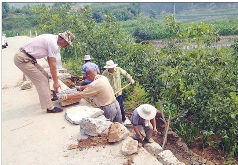
近期的连续降雨,导致章丘南部山区部分农村道路损毁严重。章丘市交通运输局组织相关人员对垛庄境内损毁严重的道路进行整修,保障了农村公路的安全畅通。
