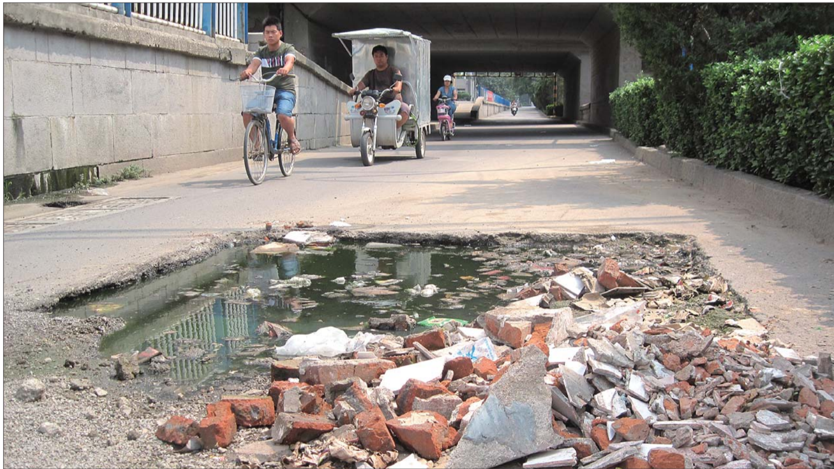
坑里很多积水、建筑垃圾,十分危险。 本报记者 吴金彪 摄
