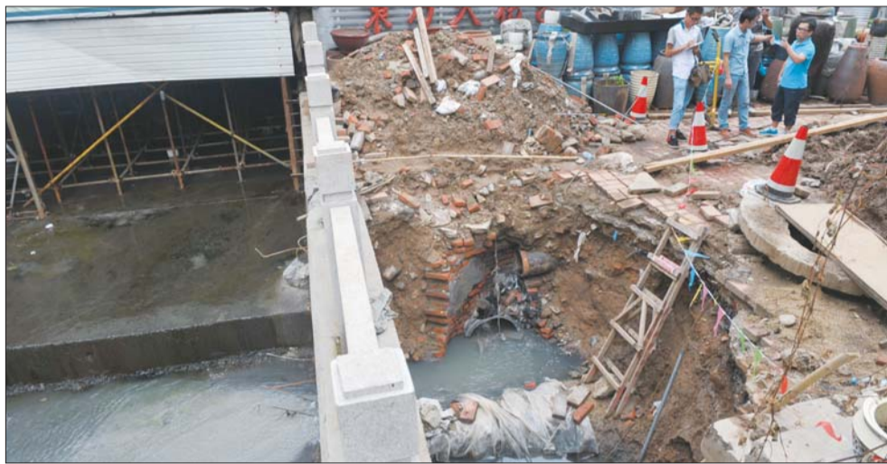
冒水的污水井西壁已经被挖开, 北侧文化西路泄洪道的混凝土墙壁被挖开了两个洞, 污水通过洞流入泄洪道内。
