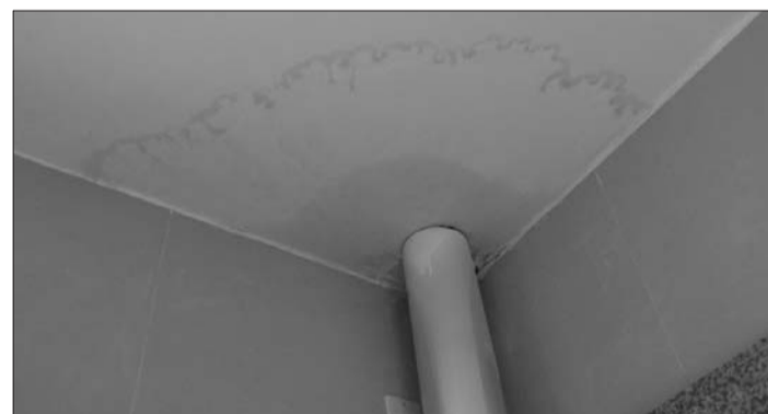
房顶因漏水湿了一大片。
