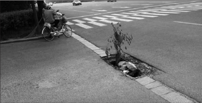
破损的雨篦子里插着干枯的树枝，提醒过往市民注意安全。
