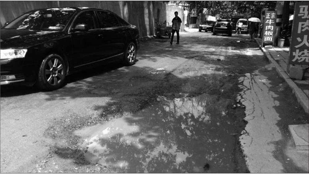
曹家巷南段路面上深坑一个连着一个，泥泞难行。
