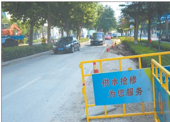
此处自来水管漏水,正在进行抢修。本报记者 王光营 摄
