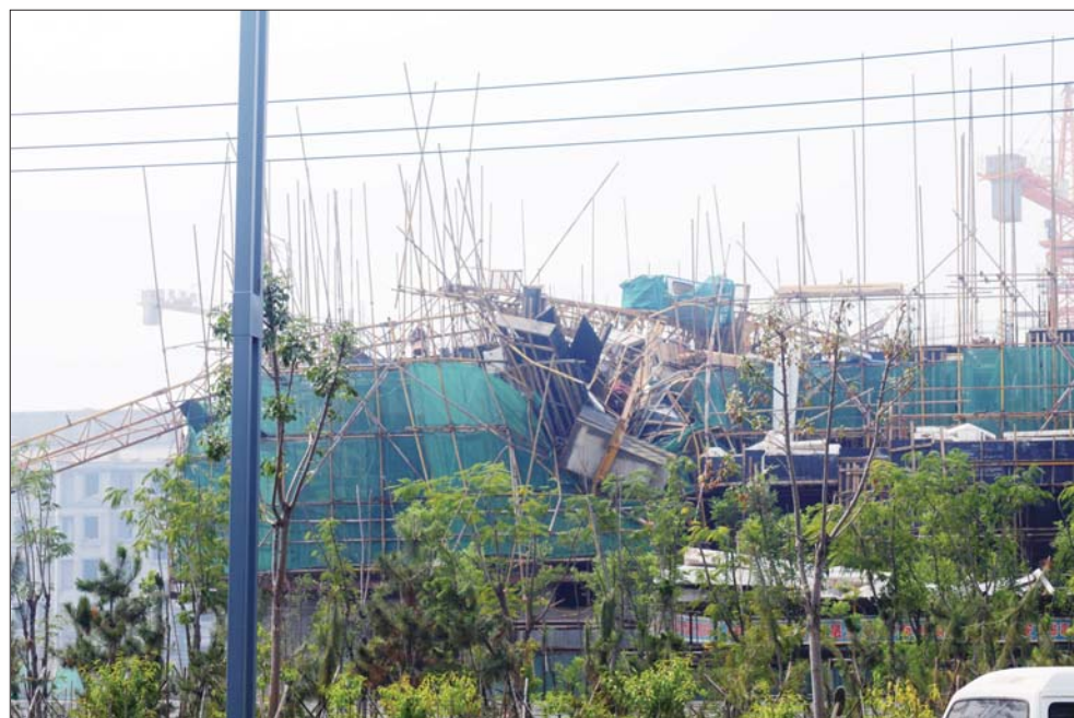
8月15日,袁桥一在建工地塔吊倾倒,事故现场一片狼藉。
