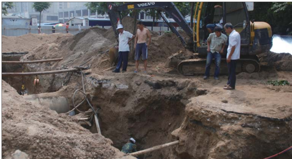
19日,施工人员在威海路改造老旧的供热管道。本报见习记者 赵发宁 摄
