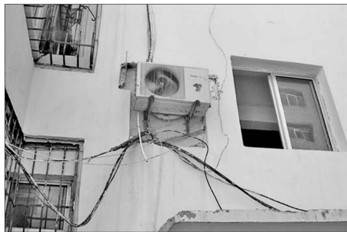
▲老旧小区不少空调外挂机的排水管都随意处置。 记者 赵兵 摄
