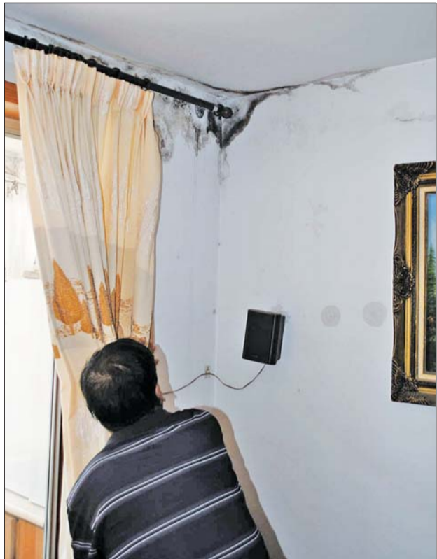
▲403室客厅南墙角发霉长毛
