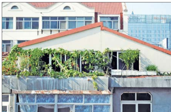
▲民主巷11号楼顶情况复杂,“平改坡”前路漫漫。
