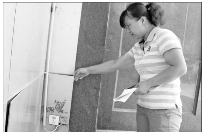
▲张玉卿查看小区的裸露电线。记者 王帅 摄
