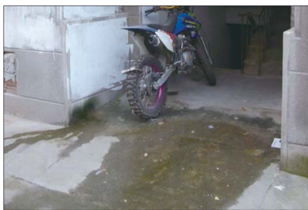
小区楼道口长满青苔。 本报见习记者 王欣 摄
