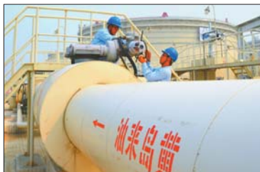
黄潍输油管线滨海末站输油管道。
