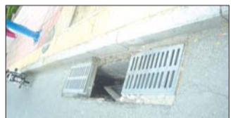
井盖坠落到排水井里。本报见习记者 胡阳 摄
