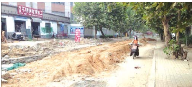
公共事业管理局正更换南关热电厂附近的雨水管道。本报见习记者 胡阳 摄
