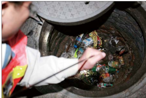
打开供水井盖里面满是垃圾杂物,孟善永面对这种情况,每次都要将杂物清理掉。
