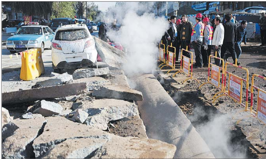
7日,黄台南路30厘米厚的路面被炸开,露出了地下热力管道。 本报记者 王媛 摄
