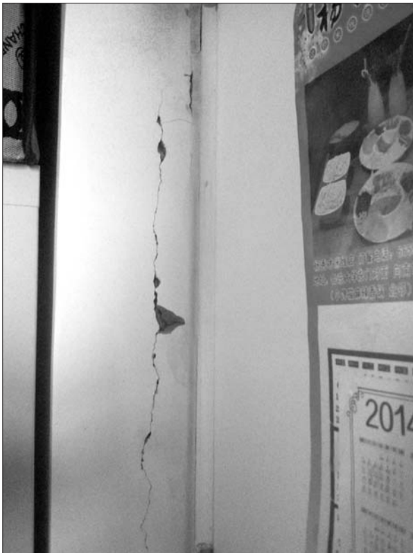
►一些宿舍的墙已经开始裂缝。 本报记者 李泊静 摄
