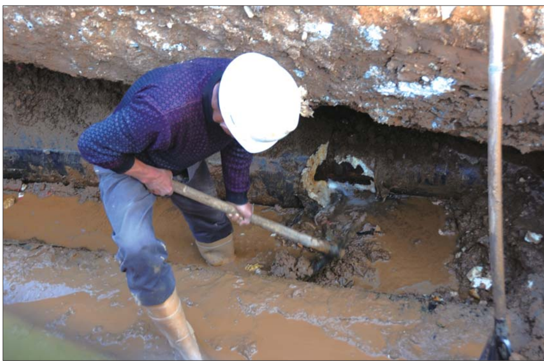
◀ 惠安小区二级暖网管道的漏点8小时漏了120吨水,工作人员在全力抢修。本报记者 韩逸 摄
