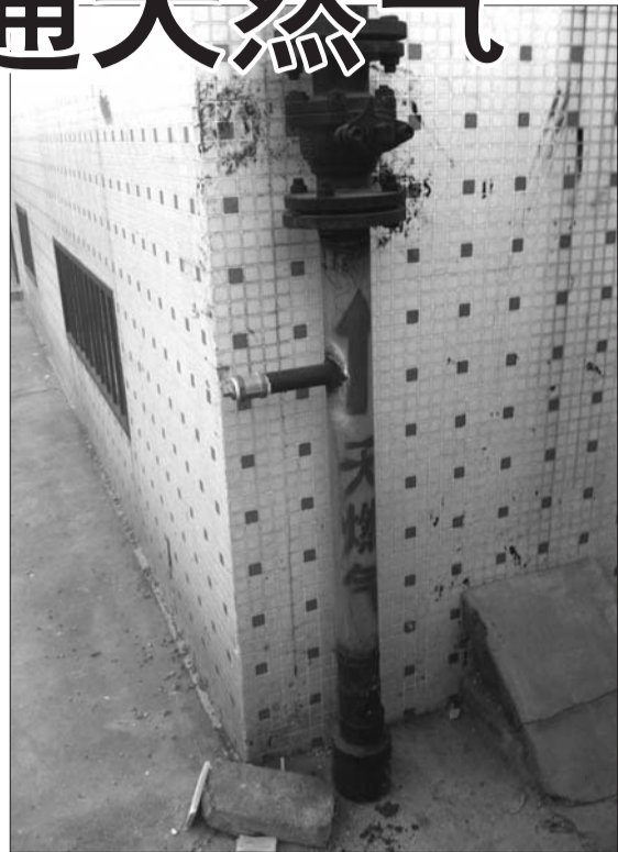
5号楼至今也没有安装天然气管道
