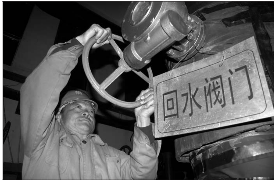
8日,在泰安望岳西路换热站,工人师傅正调试回水阀门。 本报记者 王世腾 摄
