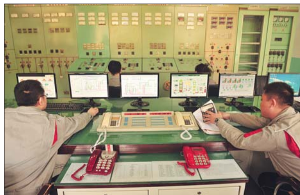
14日,济南热电供热调度中心启运,供热运行情况在大屏幕上一目了然。 本报记者 周青先 摄
